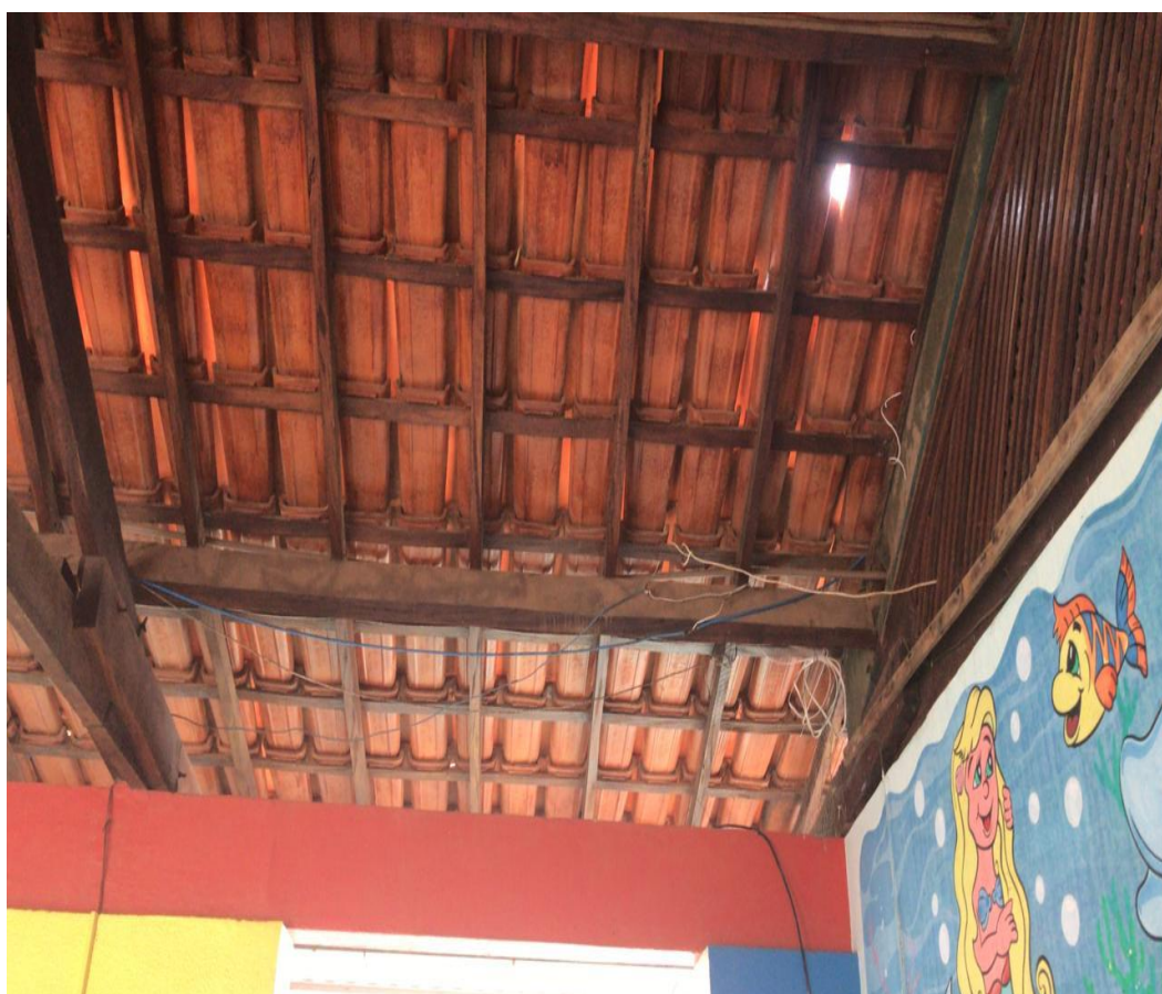
Fotos 8 – Telhas com Furos e Fiação exposta.
