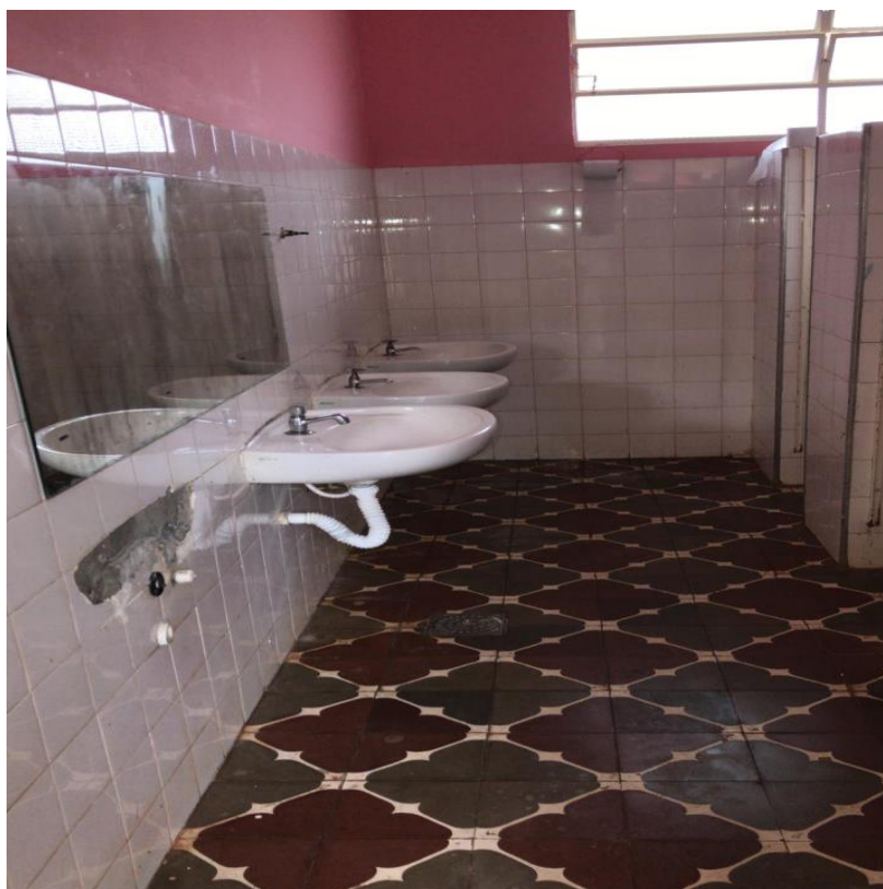
Fotos 5 – Azulejo em péssimo estado no banheiro feminino.
