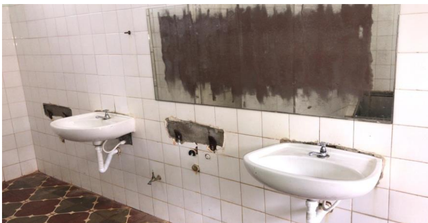
Foto 3 – Banheiro atualmente em péssimo estado.
