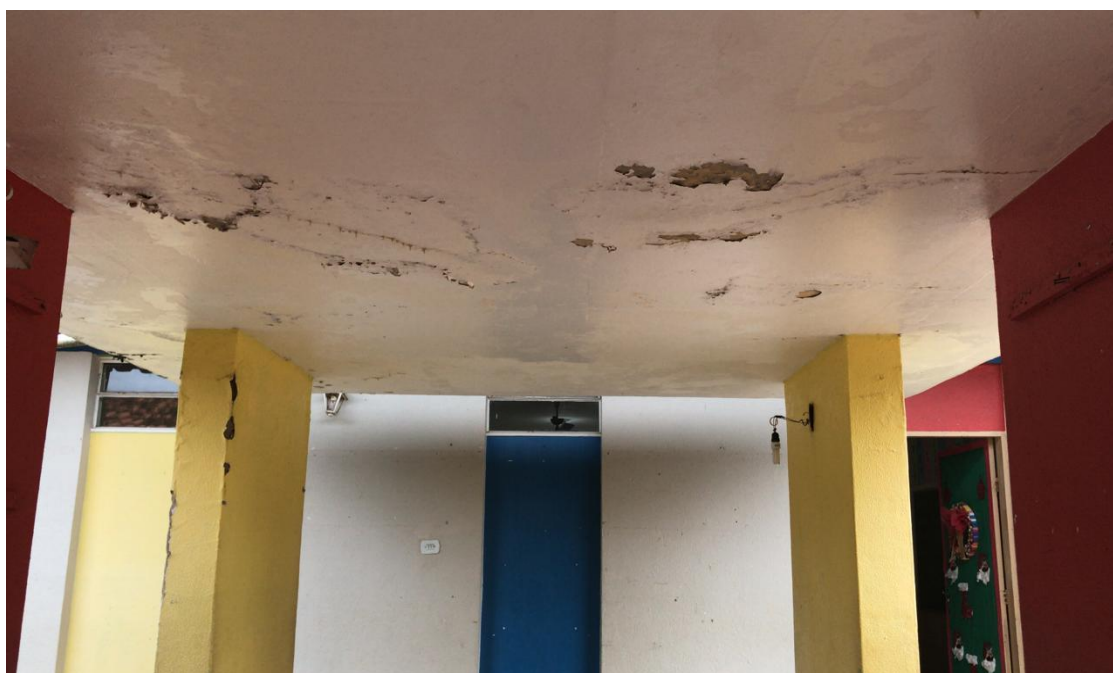
Fotos 7 – Estado deplorável de pintura em várias partes da escola.
