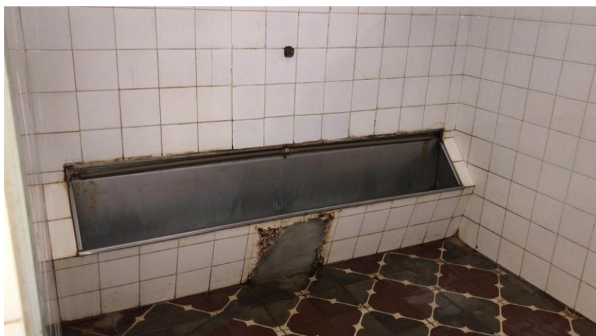
Foto 4 - Mictório em estado corrosivo.
