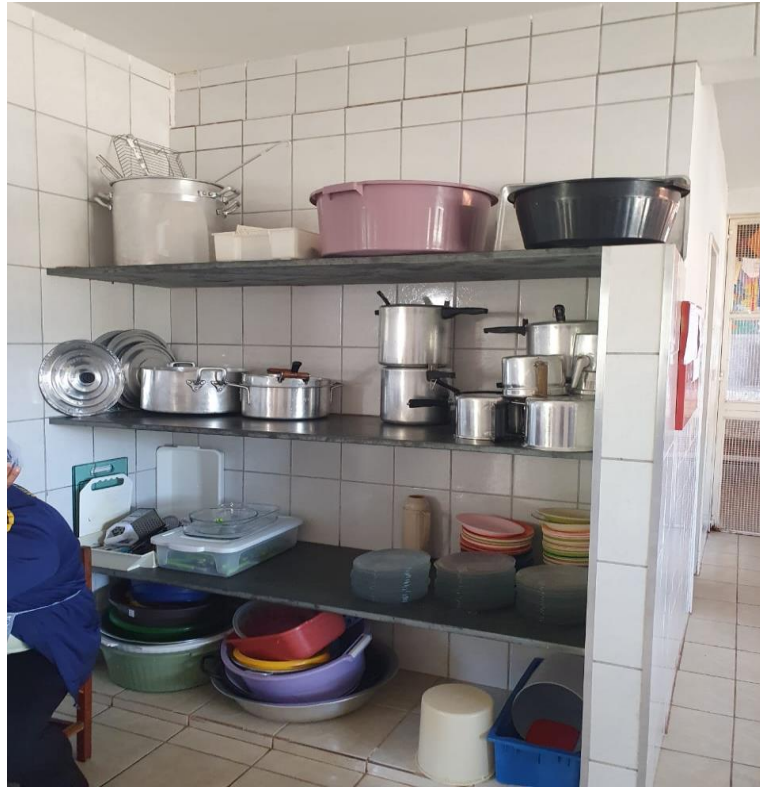
IMAGEM 10 – EXECUÇÃO DE ALVENARIA NO LADO DIREIRO ATÉ O TETO E FECHAMENTO COM PORTAS DE VIDRO
