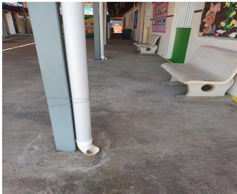
IMAGEM 13 –SERÁ FEITO AS VALAS NO PISO PARA A DRENAGEM DAS AGUAS PLUVIAS E DEPOIS O FECHAMENTO E CONTRAPISO.
