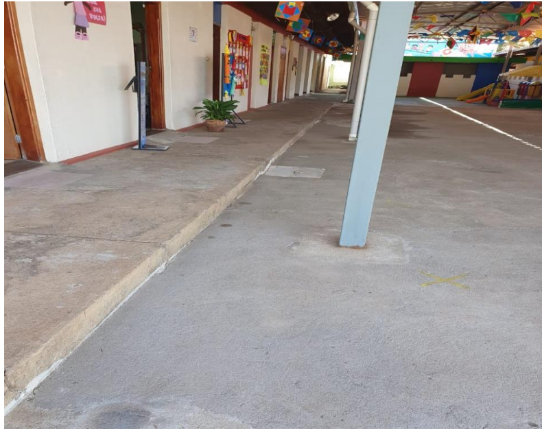
IMAGEM 14 –SERÁ FEITO AS VALAS NO PISO PARA A DRENAGEM DAS AGUAS PLUVIAS E DEPOIS O FECHAMENTO E CONTRAPISO.
