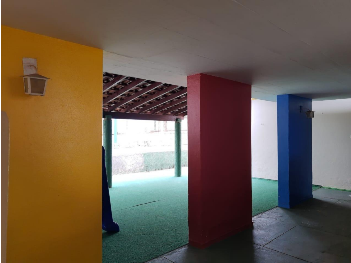
Foto 13 – Deverá fazer o fechamento desse vãos em alvenaria.
